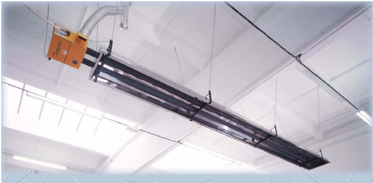
Obr. 7 Tmavý plynový zářič se samostatným spalínovým odtahem vedený přes strop do exteriéru [5].
